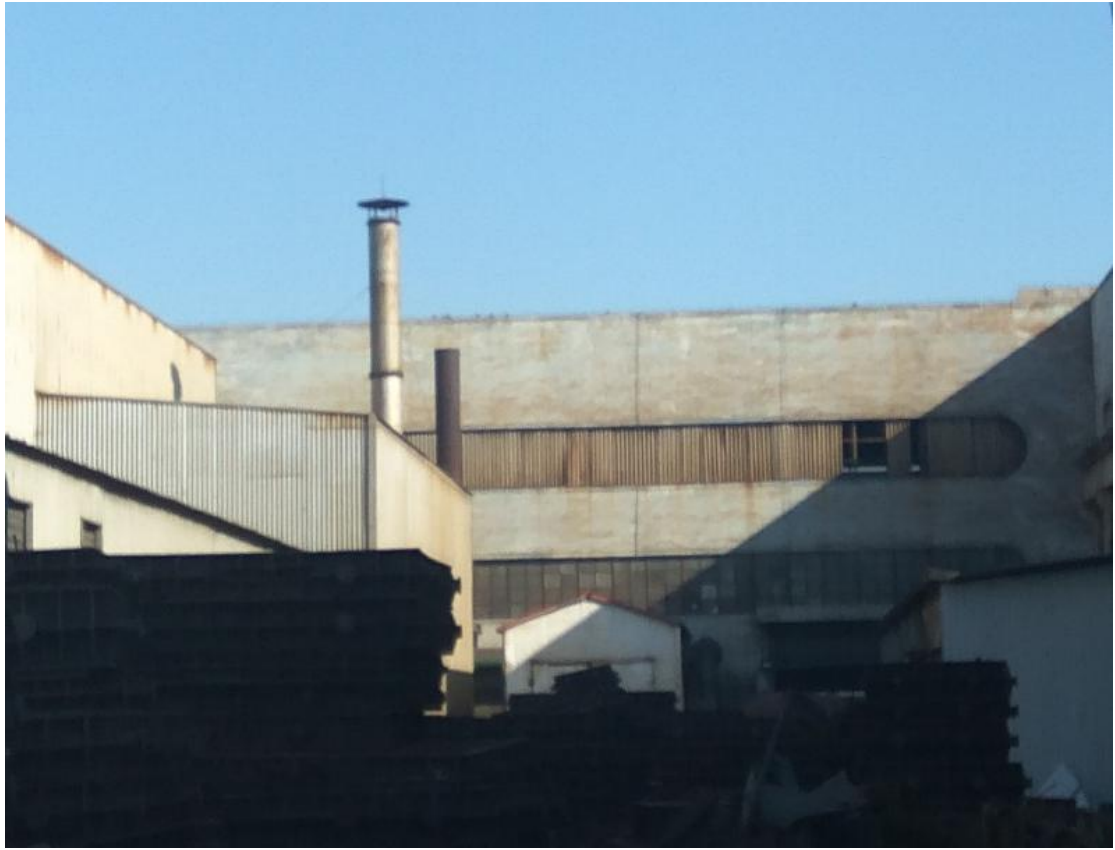
热处理窑排气筒
