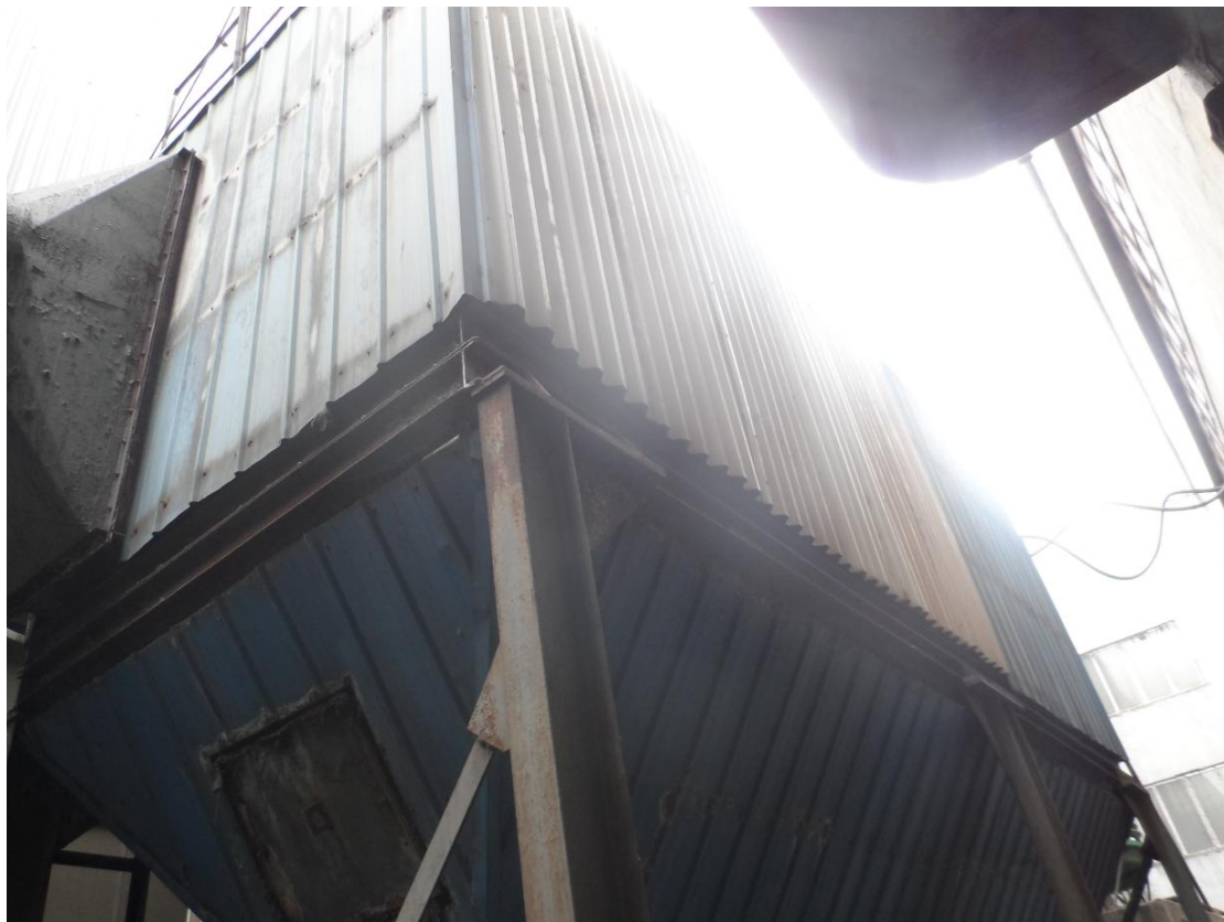
震动落砂、破碎工序布袋除尘器
